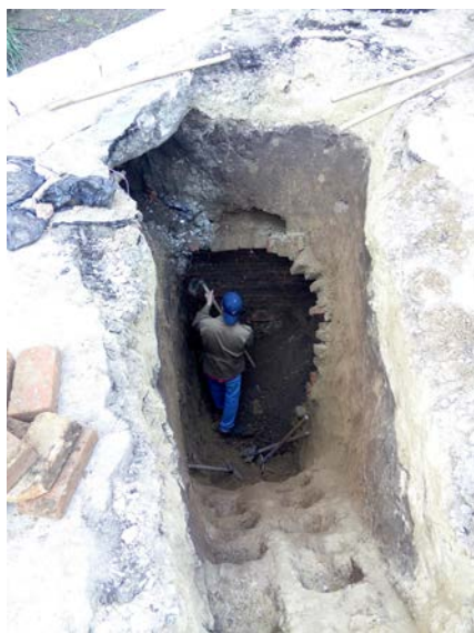
Fig. 18 Galeria de lângă sediul Procuraturii Cahul.
