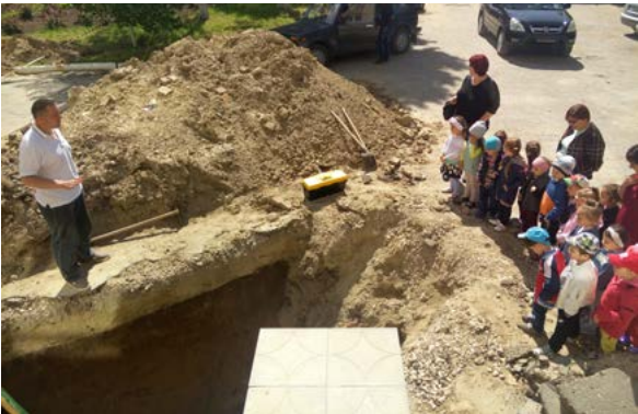
Fig. 17 Galeria de lângă sediul Procuraturii Cahul.
